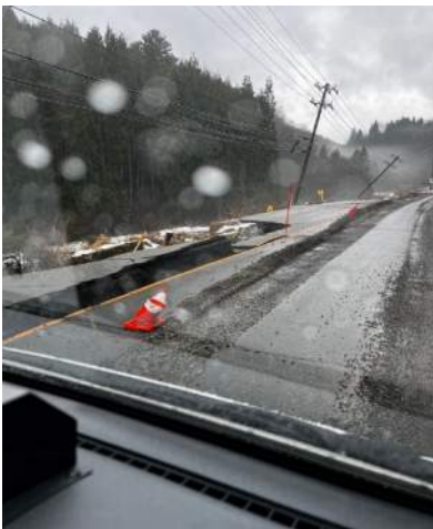
(pic2) 地震により崩落した道路
